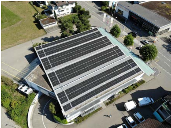
Beispiel Photovoltaik-Anlage Reiden
